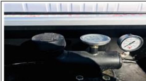
온도계, 압력계 설치 예
